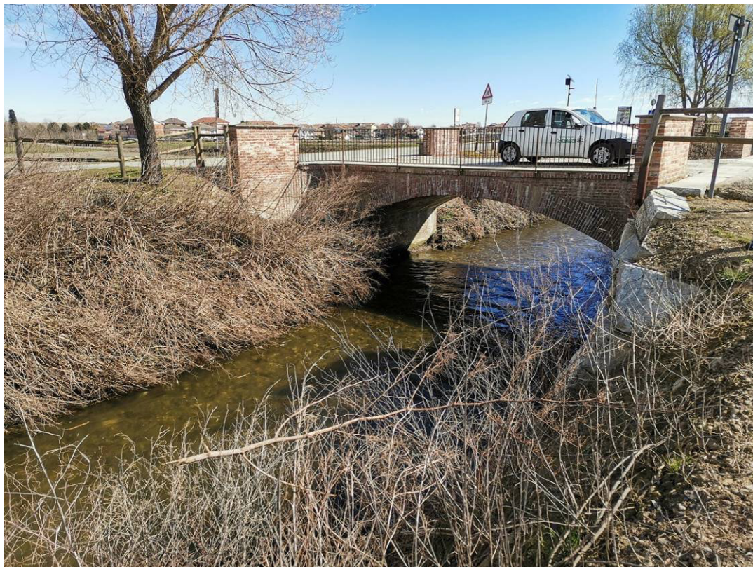
Immagine n. 11 – scogliera lungo il T. Lemina intervento 4: vista da monte del ponte esistente
