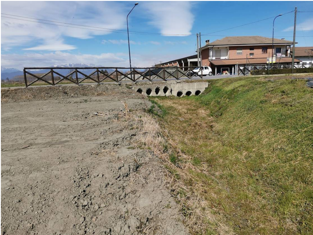
Immagine n. 3 – zona via Umberto I intervento 2: vista da valle delle tubazioni esistenti di scarico
