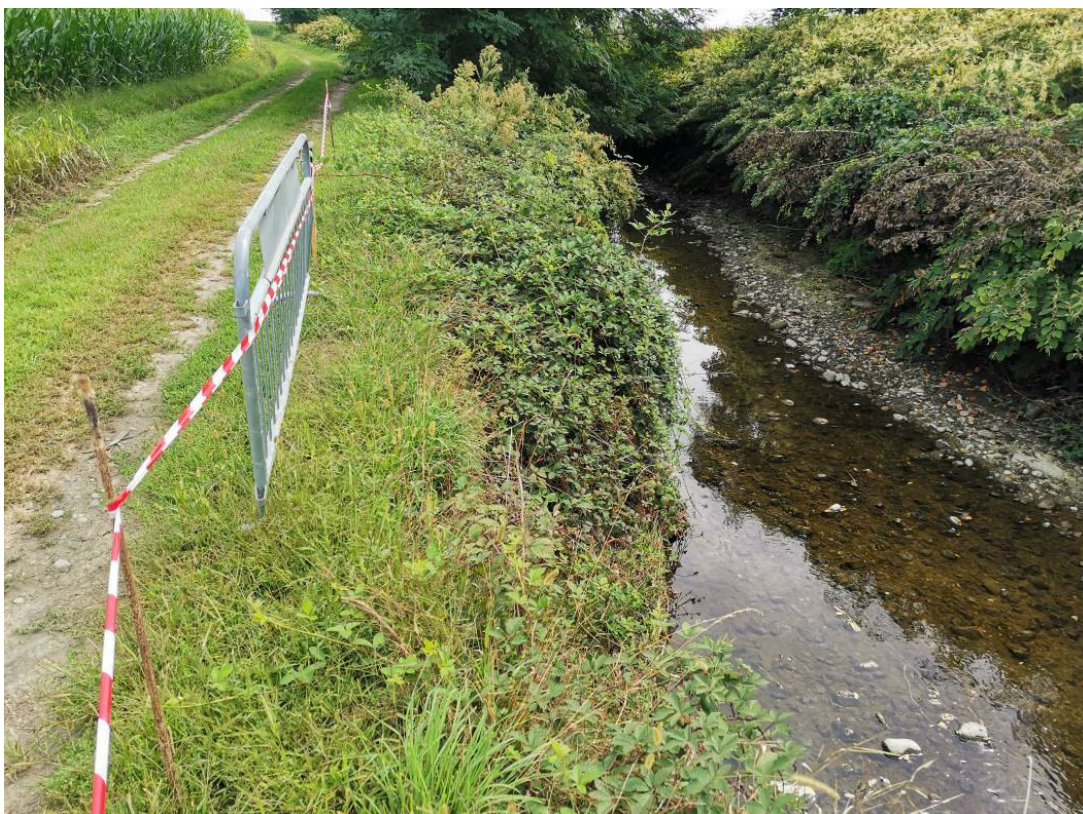
Immagine n. 8 – realizzazione scogliera intervento 3: vista della lunata erosiva sponda sx T. Lemina verso valle e tratto oggetto di pulizia sponde
