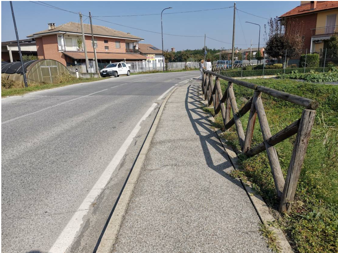
Immagine n. 5 – zona via Umberto I intervento 2: parapetto in legno oggetto di rifacimento su cordolo in c.a.
