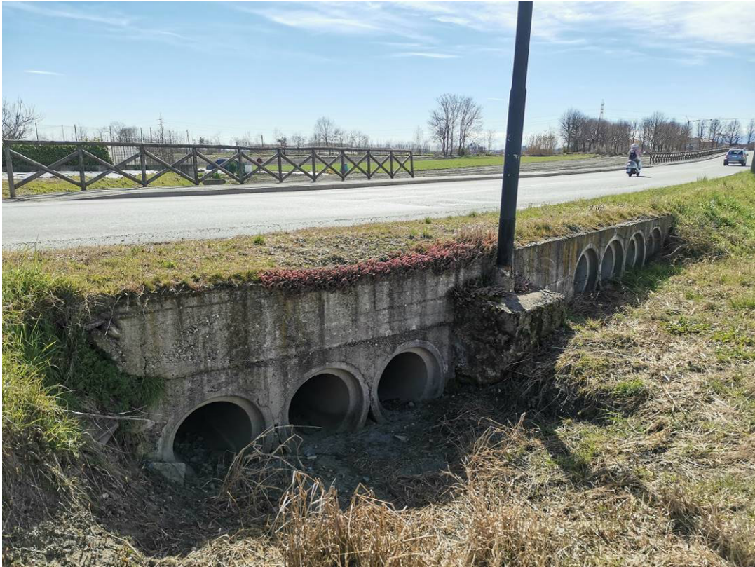
Immagine n. 2 – zona via Umberto I intervento 2: imbocco a monte strada delle tubazioni esistenti di scarico
