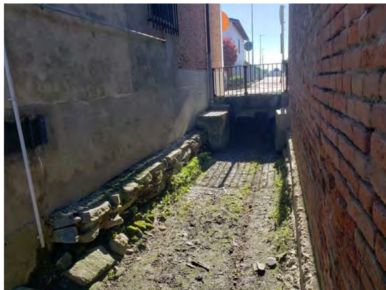
Figura 11.6.1: Manufatti sporgenti in alveo da fabbricati esistenti
