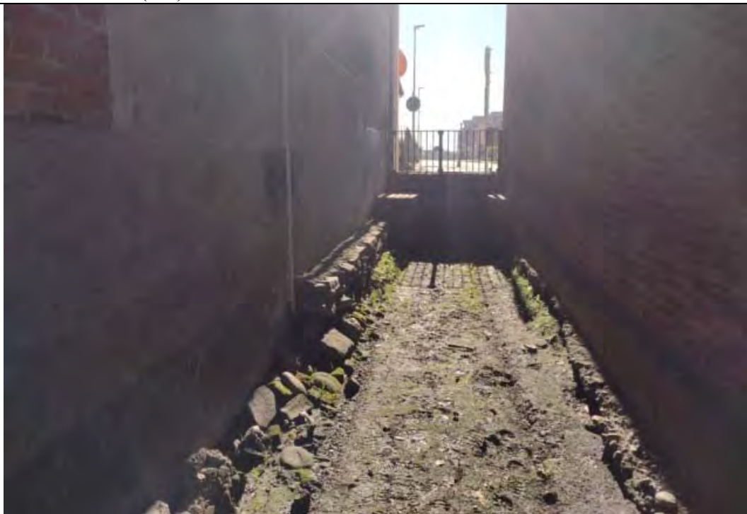
Figura 2.2.1: Tratto iniziale Gora a valle via XX Settembre (direzione di flusso dall'alto verso il basso)
