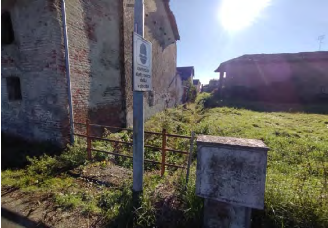
Figura 2.2.5: Immissione del canale al di sotto di via Circonvallazione (direzione di flusso dall'alto verso il basso)
