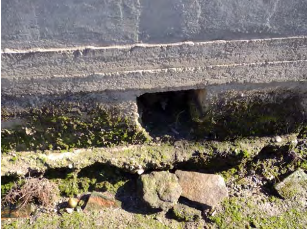
Figura 2.2.6: Scarico acque meteoriche in destra orografica (direzione di flusso da destra verso sinistra)
