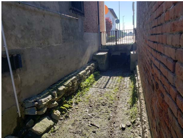
Figura 11.6.1: Manufatti sporgenti in alveo da fabbricati esistenti
