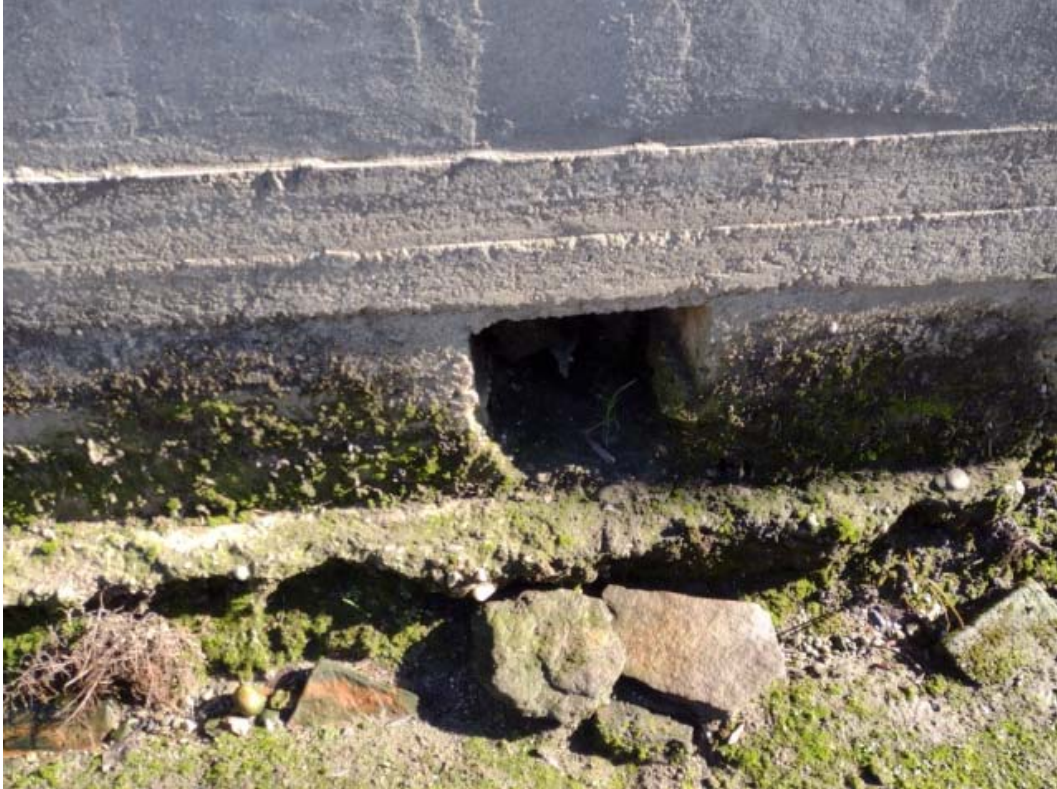
Figura 2.2.6: Scarico acque meteoriche in destra orografica (direzione di flusso da destra verso sinistra).
