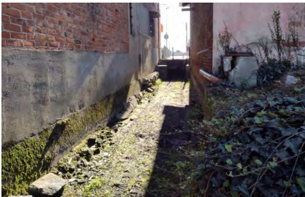
Figura 2.2.2: Tratto iniziale della Gora compresa tra dei fabbricati (direzione di flusso dall'alto verso il basso)
