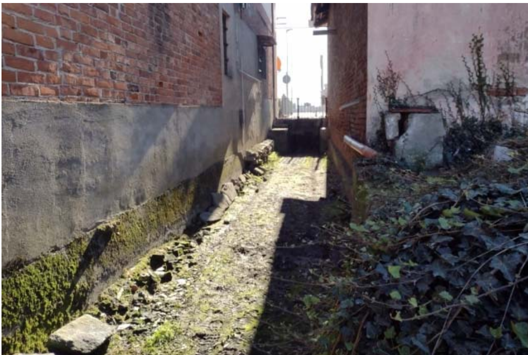
Figura 7: tratto iniziale della Gora compresa tra la muratura dei fabbricati (direzione di flusso dall'alto verso il basso).
